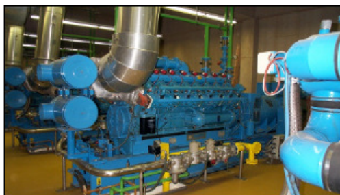
Fotó: A miskolci hulladéklerakóból származó biogázra épülő energia-előállítás és távfűtési rendszer
