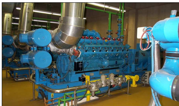
Miskolc: co-generazione col gas dalla discarica e sistema di teleriscaldamento
