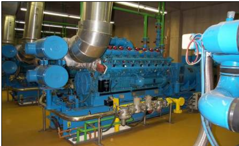
Durch Deponiegas betriebene KWK- und Fernwärmanlage von Miskolc
